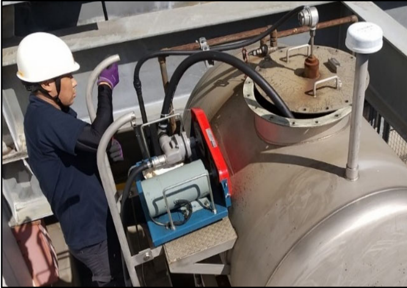
北海道の某企業における屋上タンクの燃料入替え（2023年8月） 〔※作業を行うにあたって消防申請をしております。〕
