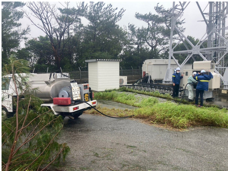
某通信会社基地局の発電機用燃料給油 2023年8月8日
